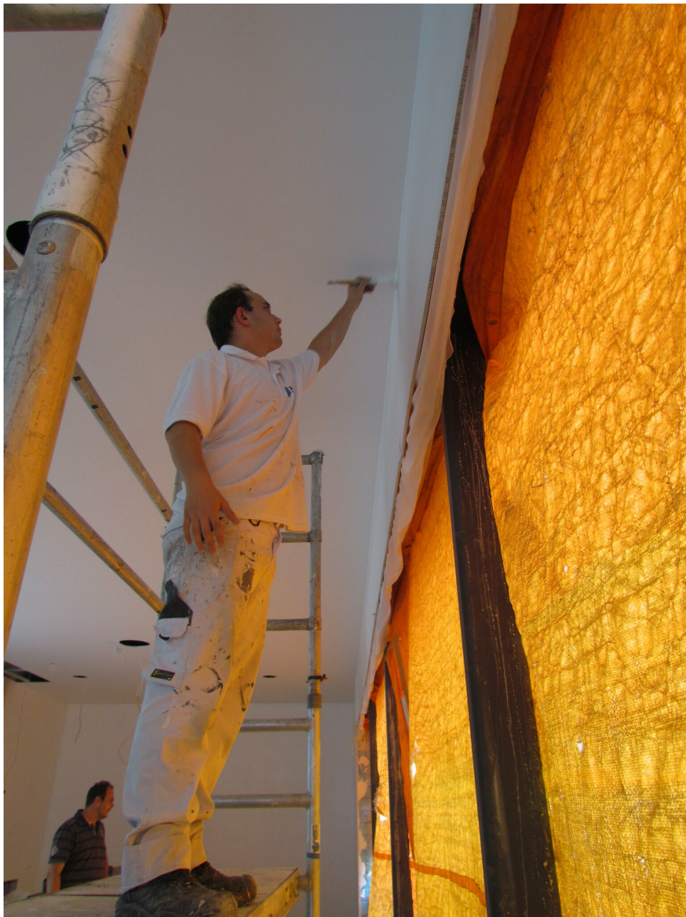
Justin van Wely gebruikt voor de muren kwast en roller. Het plafond wordt gespoten
